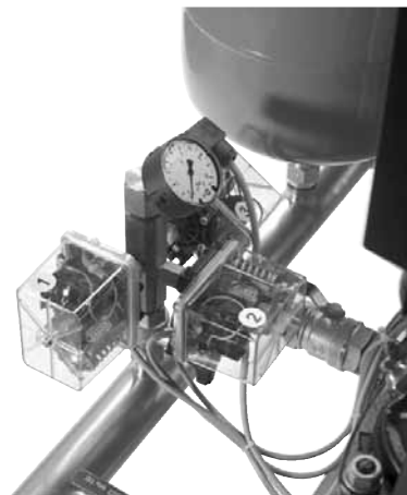
Fig. 22 Interruptores de presión en el colector
